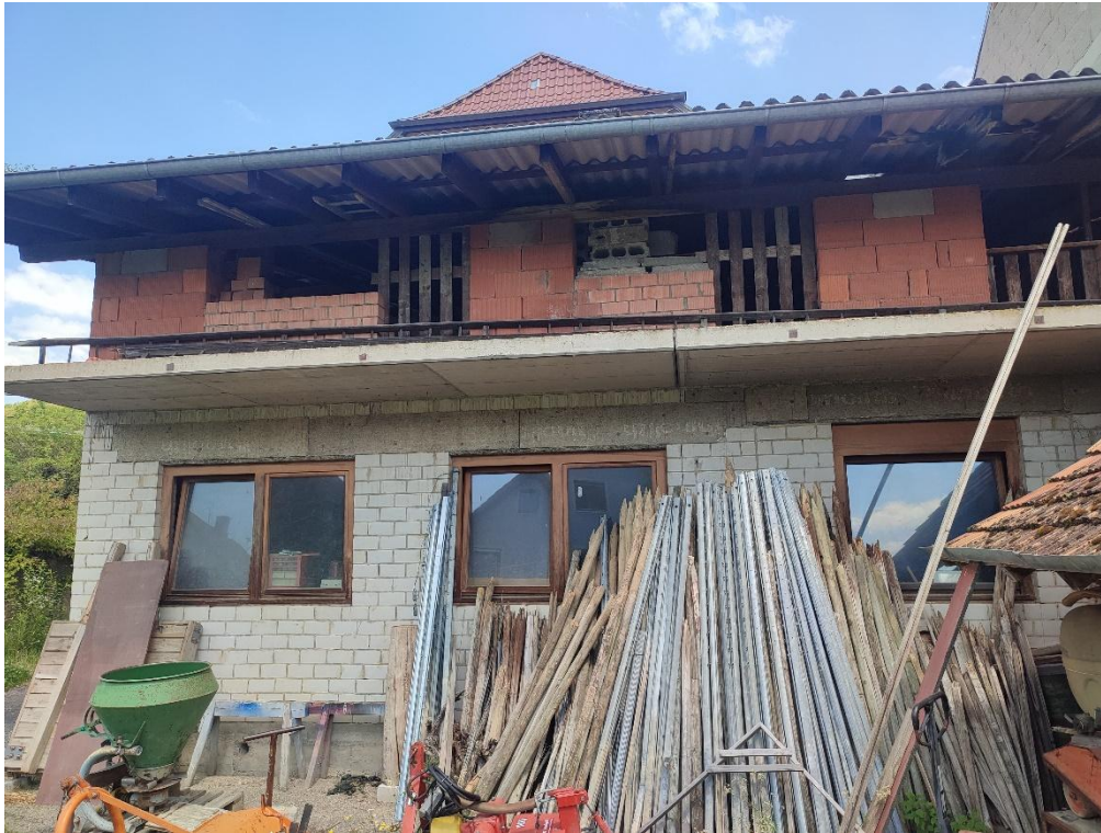
Abb. 6: Gebäude auf dem Flst. Nr. 118/1. Das Gebäude ist zugig und im Dachbereich offen ohne doppelte Decke.
